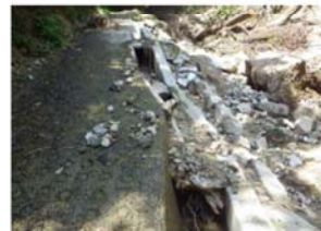
水路が土砂で埋まっている土砂の除去が必要
