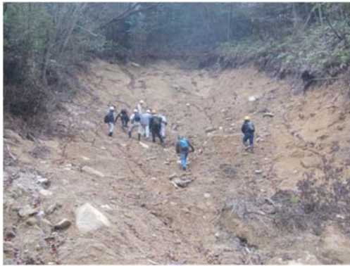
土石流発生の源頭部の崩壊地
