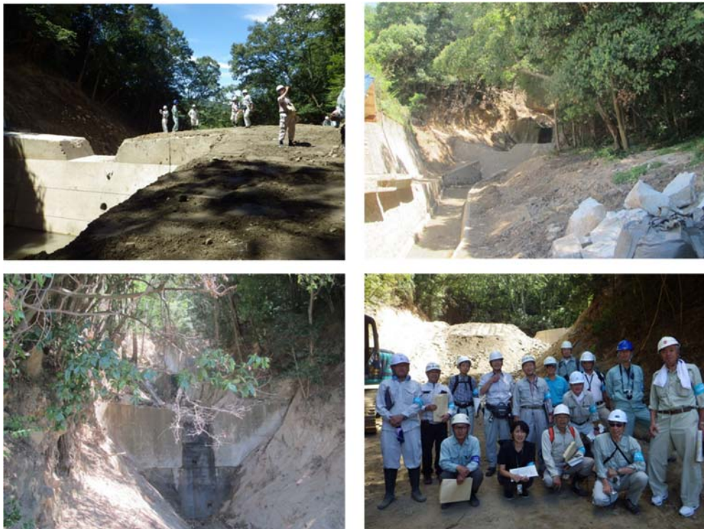
図 3-6 矢野東地区の治山ダム（平成 30 年 2 月設置）を超えた土砂流出箇所調査状況
