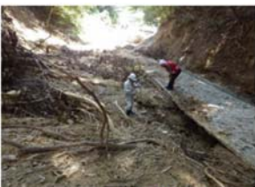
墓参道床版の下の地山が流出床版が浮いている
