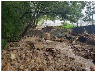
土石流の流下部 (土砂がほとんど堆積していない)
