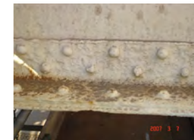
激しく腐食した床桁
