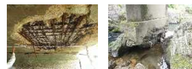
道路施設(橋梁)の老朽化
