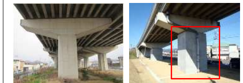
補強が必要な橋脚
