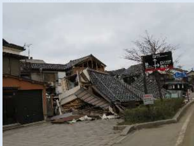
輪島市内被災状況(輪島市河井町地内)
