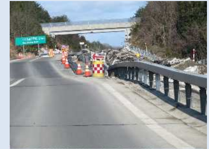
のと里山海道被災状況 路面沈下(輪島市三井町)
