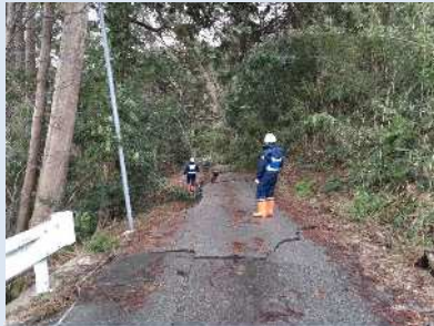
崩落した道路の被災概況調査 (輪島市河井町)
