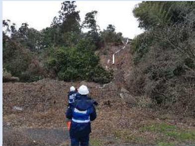
崩落した道路を斜面下から被災概況調査 (輪島市河井町)
