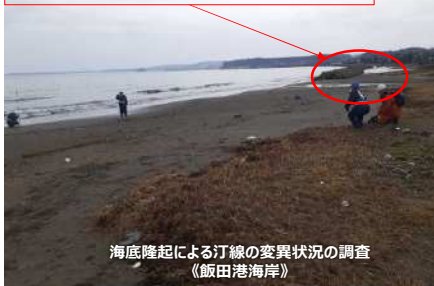
隆起による汀線変位の影響を受けた離岸堤
