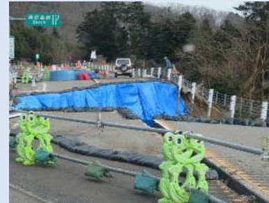
のと里山海道被災状況 道路崩落(七尾市中島町)
