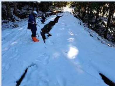
雪の中を被災概況調査 (輪島市三井町)
