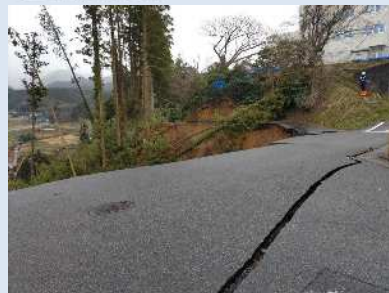
R6.1.31 被災状況調査(輪島市河井町地内)
